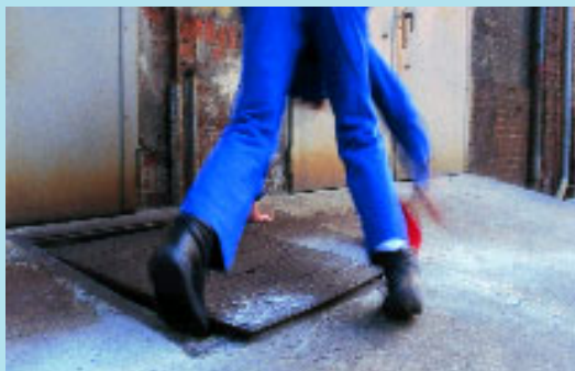
Wer schaut beim Gehen schon immer auf den Weg? Eine verrutschte Bodenabdeckung wird zur tückischen Stolperfalle
