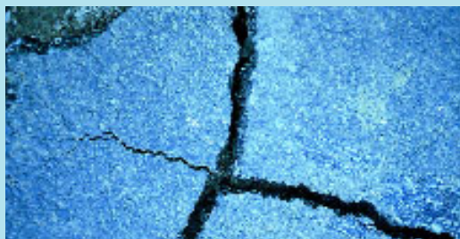
Typischer Winterschaden: Nach der frostigen Jahreszeit gilt es, Wege in Außenbereichen wieder zu glätten
